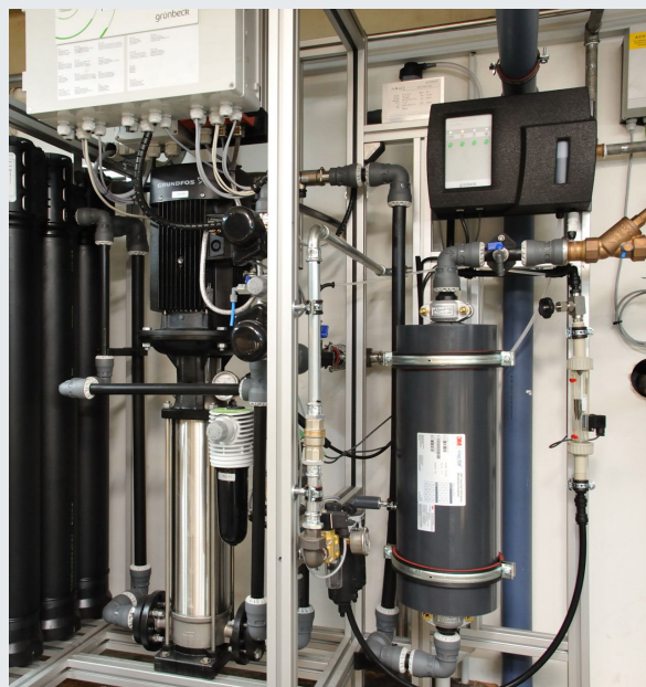
Abbildung 4: Kompakt: Für die neue Grünbeck-Umkehrosmoseanlage musste Fendt die vorhandene Empore nur minimal erweitern. Denn die Anlage benötigt weniger als einen Quadratmeter Stellfläche.
